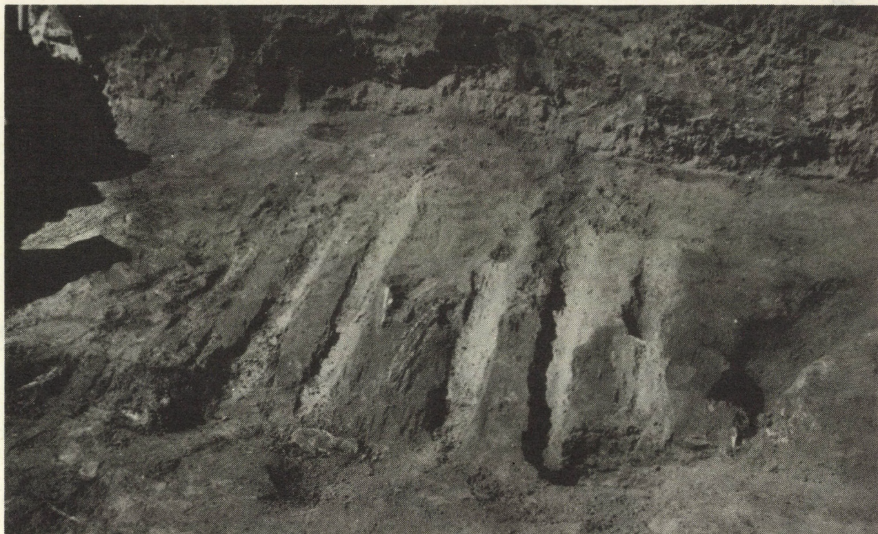
8. kép A beszakadt kamratető Abb. 8. Das eingestürzte Kammerdach
